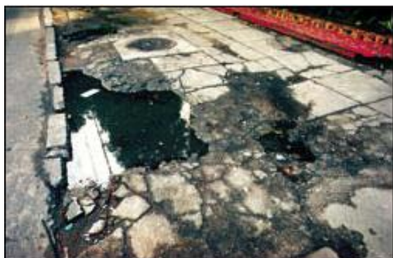
Buracos no passeio
