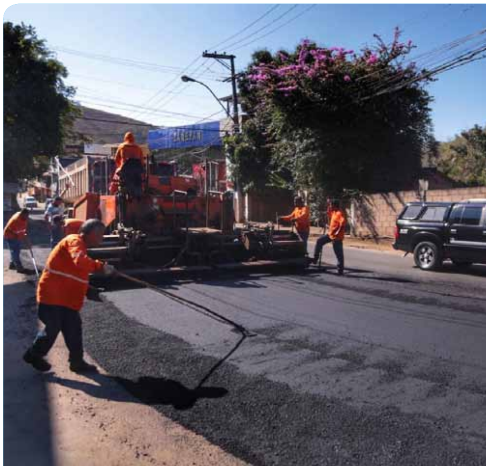
São priorizados os trechos com asfalto mais deteriorado
