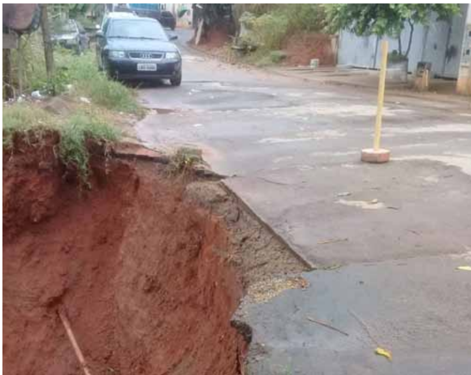
Intervenções vão recuperar a via, danificada por rompimento de drenagem
