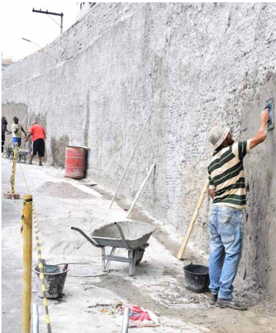
Equipes finalizam a revitalização do muro da rua Rui Barbosa, que receberá a pintura
