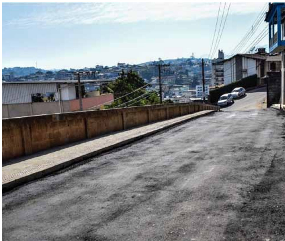
Reconstrução da rua José Turini, no Recanto, é uma das melhorias finalizadas pelo município
