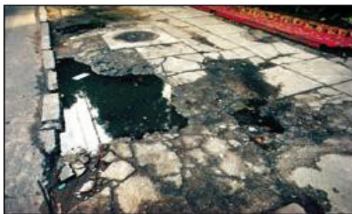
Buracos no passeio
