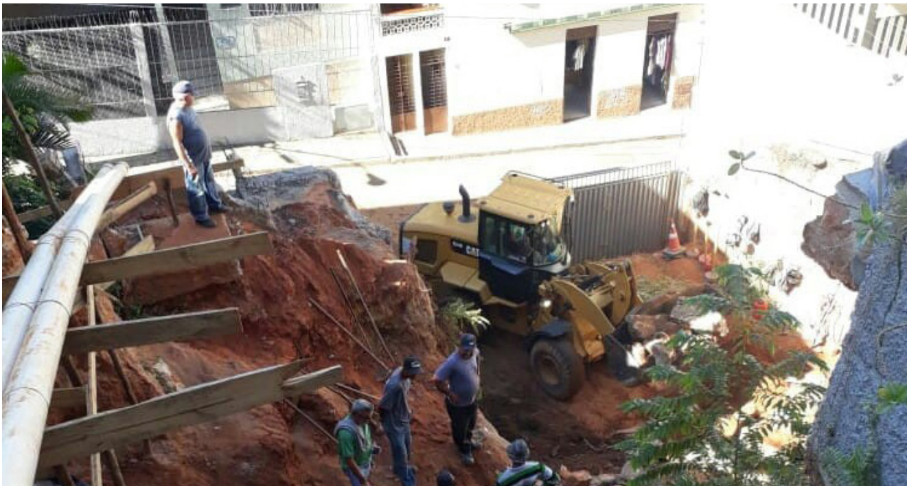
Seguem ali os serviços para retirada do concreto e da terra para dar lugar à base do muro
