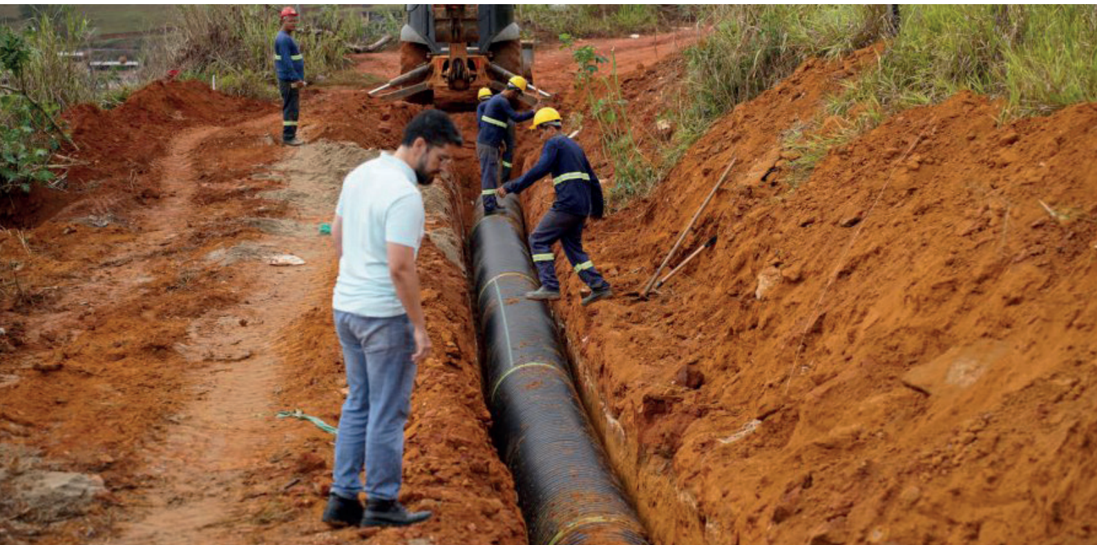
Prefeito Victor Coelho vistoriou trabalhos de instalação de drenagem pluvial nos bairros
